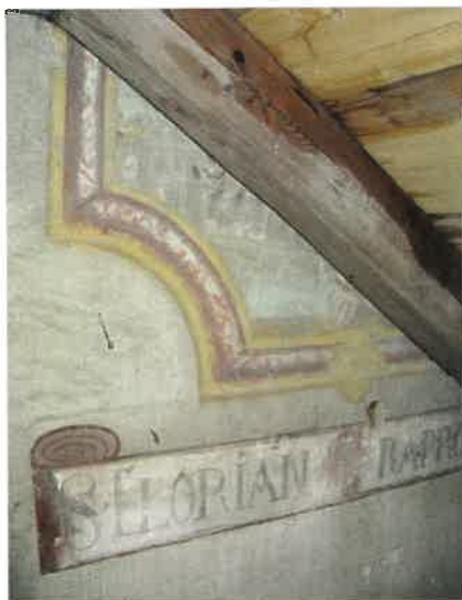
Abb. 5 Vom Dachstuhl des Anbau angeschnittenes und später übermaltes Wandbild mit der Darstellung des Hl. Florian.
